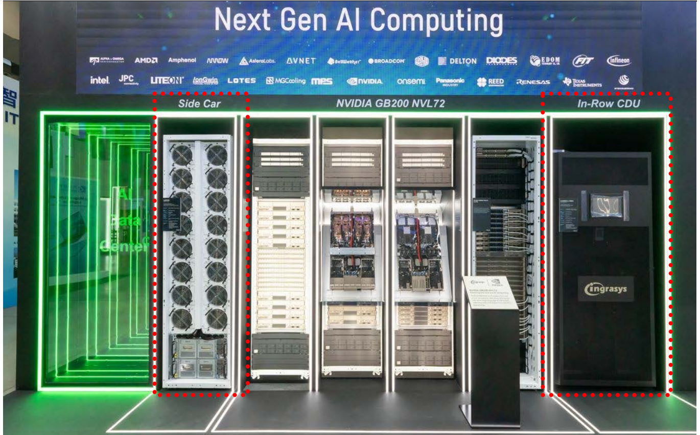
圖 7: GB 機櫃搭配液冷散熱 Sidecar / in-ROW CDU, 未來將支援多櫃 IT 機櫃以提升資料中心之坪效
